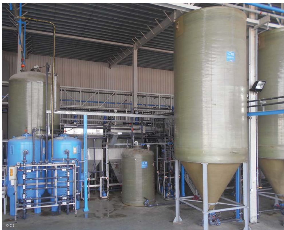
Un impianto di trattamento delle acque reflue sviluppato da CIE Srl.
