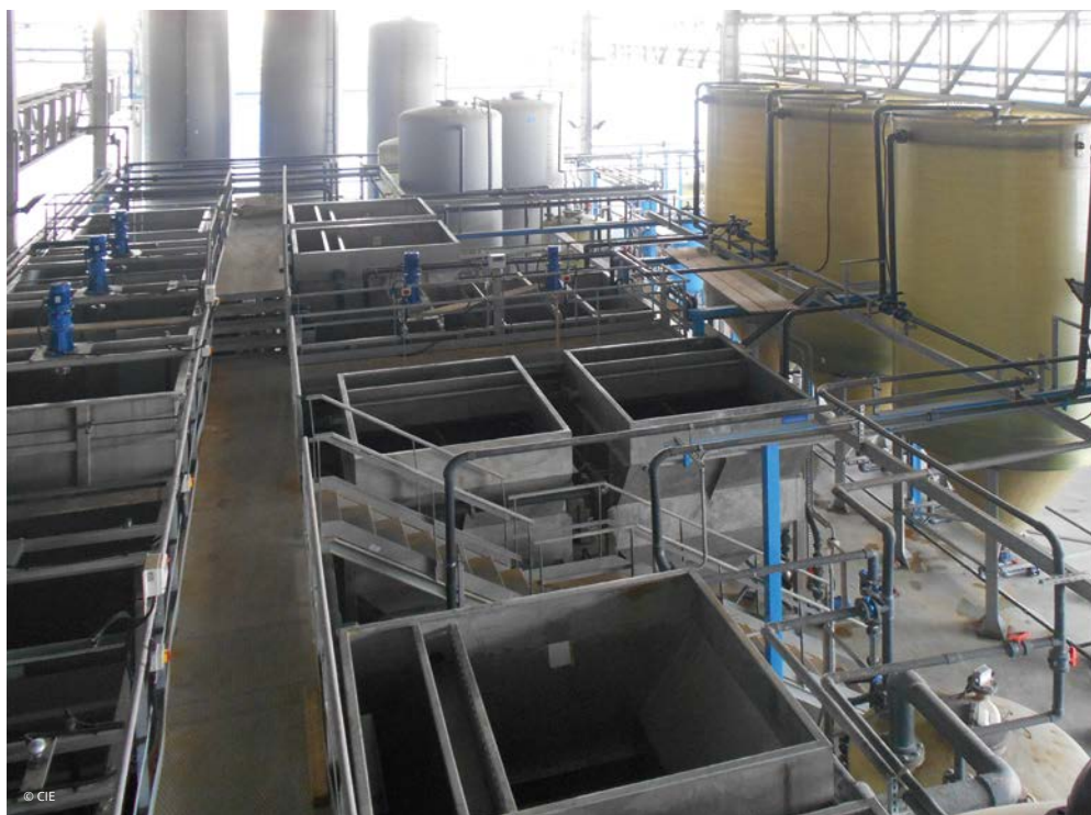
Vasche di trattamento chimico-fisico.
