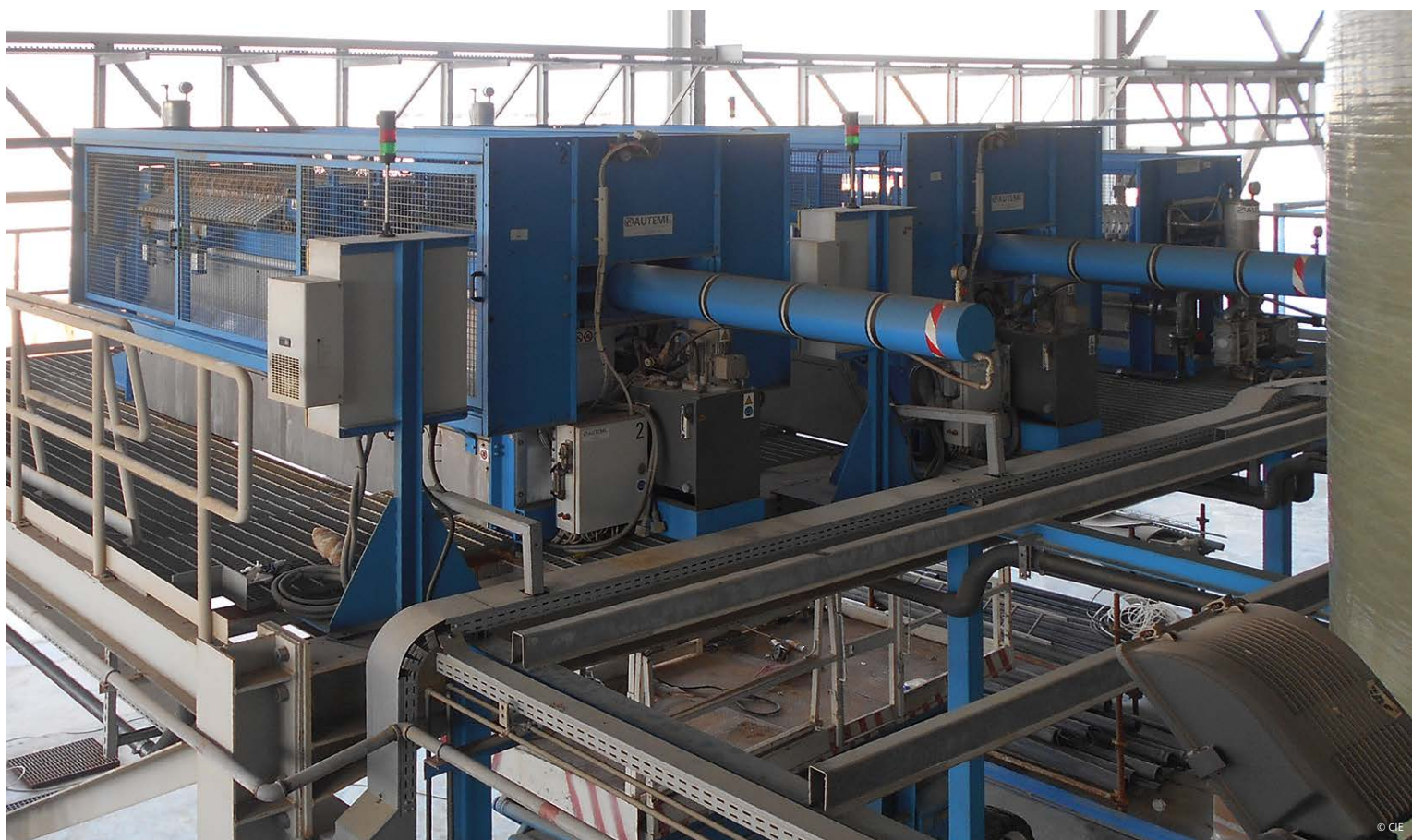
L'impianto completamente automatico per il trattamento chimico-fisico delle acque reflue di CIE presso lo stabilimento di TALEX, Abu Dhabi.
